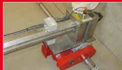
Bypass in Spotmix Förderleitung
